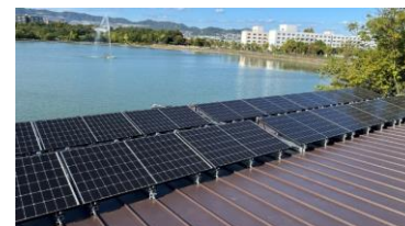
太陽光発電設備
