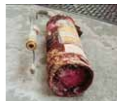
本体が錆びた消火器
