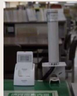
【非常通報装置】
