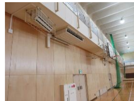
笹原小学校の設置例
