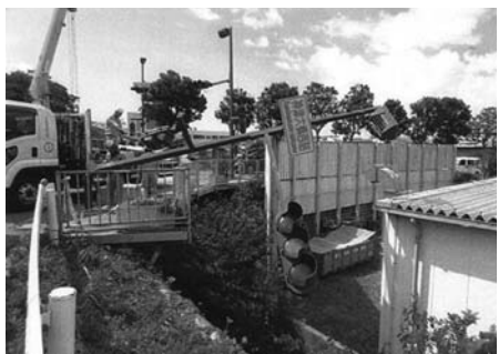
台風で倒れた信号機
