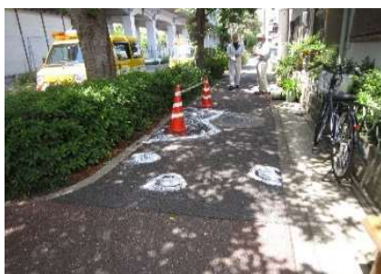
図 2-1 歩道根上がり状況 (新幹線北側道線)
