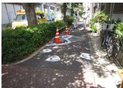
図 2-1 歩道根上がり状況 (新幹線北側道線)
