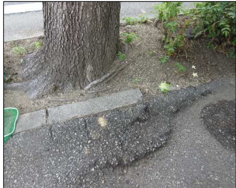
根上りによる通行障害
