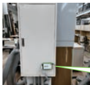
設備へのエニマス設置
