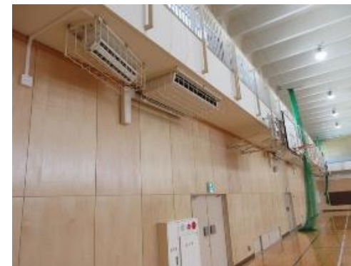
笹原小学校の設置例
