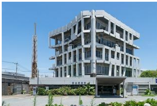
被災した宇土市役所
