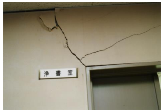
壁面のひび割れ
