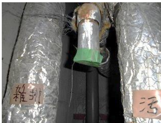
老朽化した配管設備
