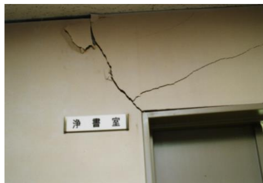
壁面のひび割れ
