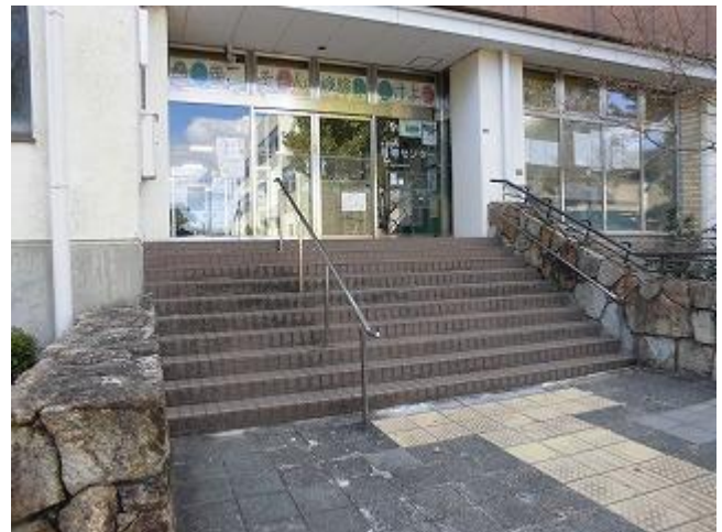
出入口の段差
