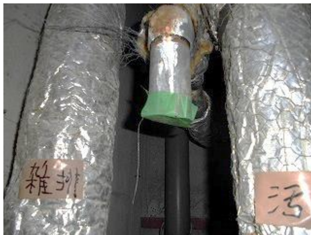
老朽化した配管設備
