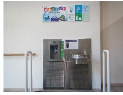
スワンホールに設置した給水スポット
