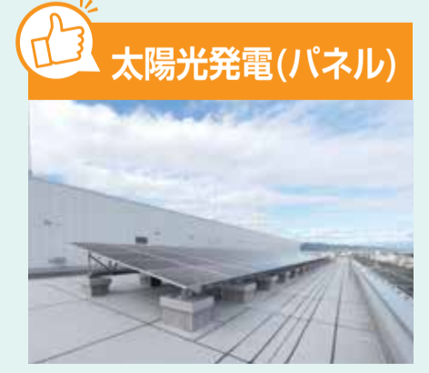
省エネ効果をもたらす屋上に設置した太陽光パネル
