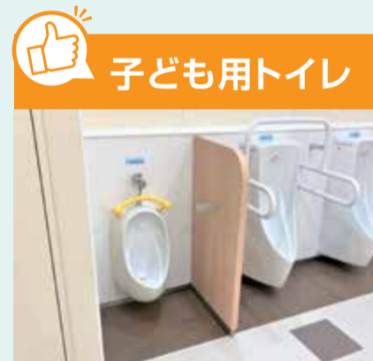
1、2階の男子トイレ(東側)には子ども用小便器を設置
